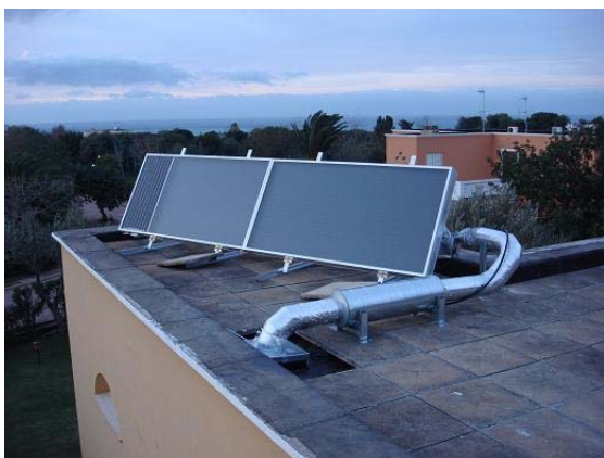
Figura 5. Il sistema solare termico ad aria installato sul tetto di questa casa di Terrasini (PA) ha praticamente risanato e ridotto il valore ad una casa altrimenti inabitabile (Immagine per gentile concessione di M. Pecoraino).
