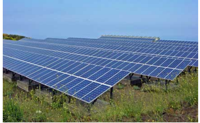
Figura 11. La centrale fotovoltaica da 100 kW nella frazione di Ginostra, sull'isola di Stromboli, ha richiesto il trasporto dei materiali e delle squadre di montaggio in elicottero. (Immagine per gentile concessione di Randazzo Energy Team).
